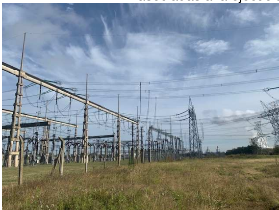
Foto 13. Tomada sobre el cerco perimetral de la zona activa de 500 kV en el sector donde entran dos líneas de 500 kV que vienen de ET Rodríguez y tres líneas de 500 kV que vienen de la Central Termoeléctrica Genelba.
